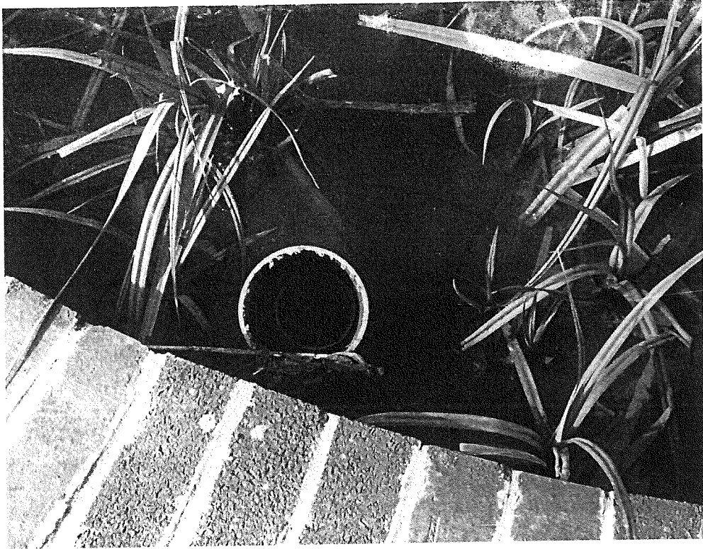
Σύστημα 2, σωλήνας αερισμού
